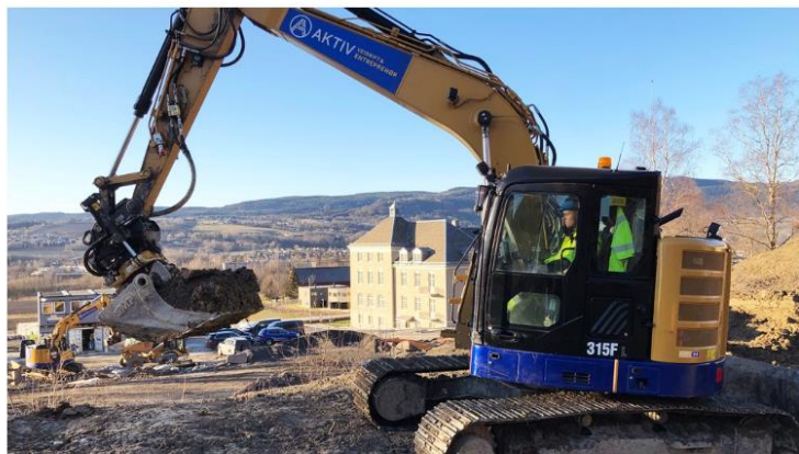
Et byggeprosjekt i Lier er i gang. Lier Hageby skal bestå av flere sammenkjedede eneboliger. FOTO: DANA KHALOUF / NRK
