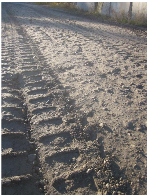
Figur 19. Til dels dårlig grusvei.
